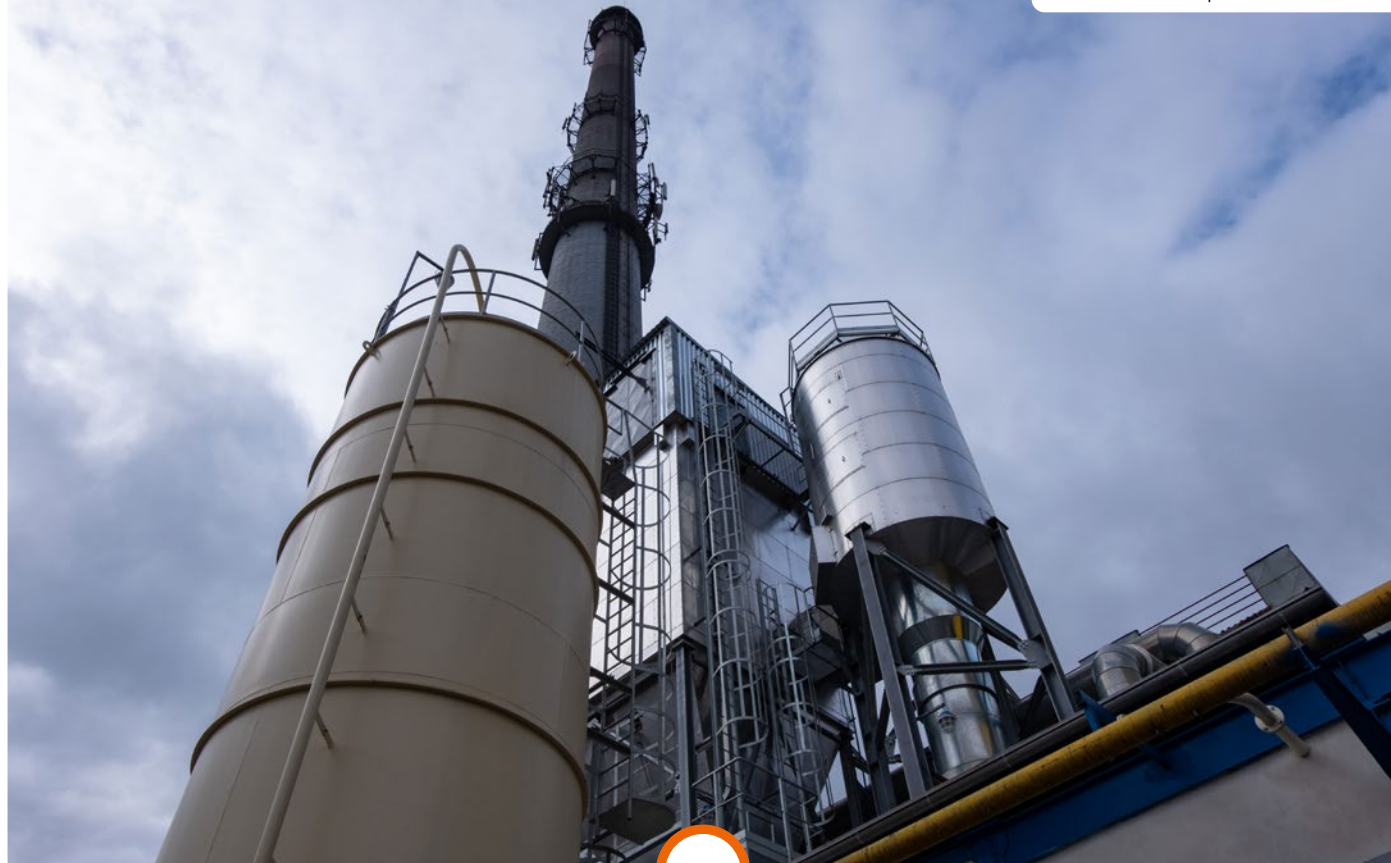
Odsíření a odprášení kotle K7
