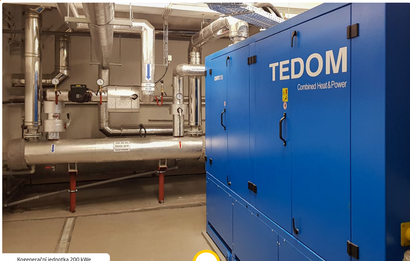
Kogenerační jednotka 200 kW e
