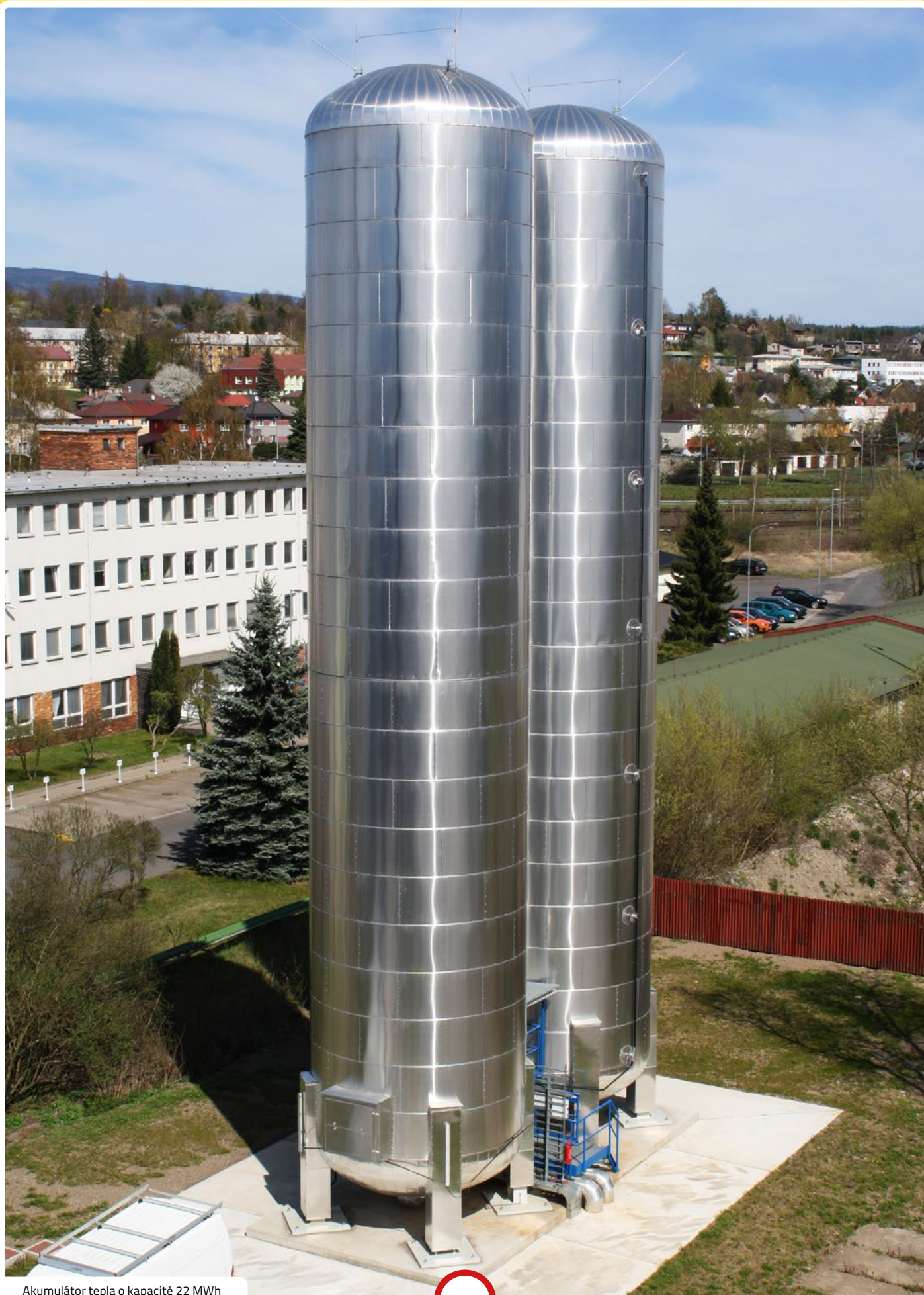
Akumulátor tepla o kapacitě 22 MWh
