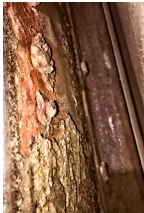
Obr. 3 – zkorodovaná část elektroodlučovače po půl roce provozu.
