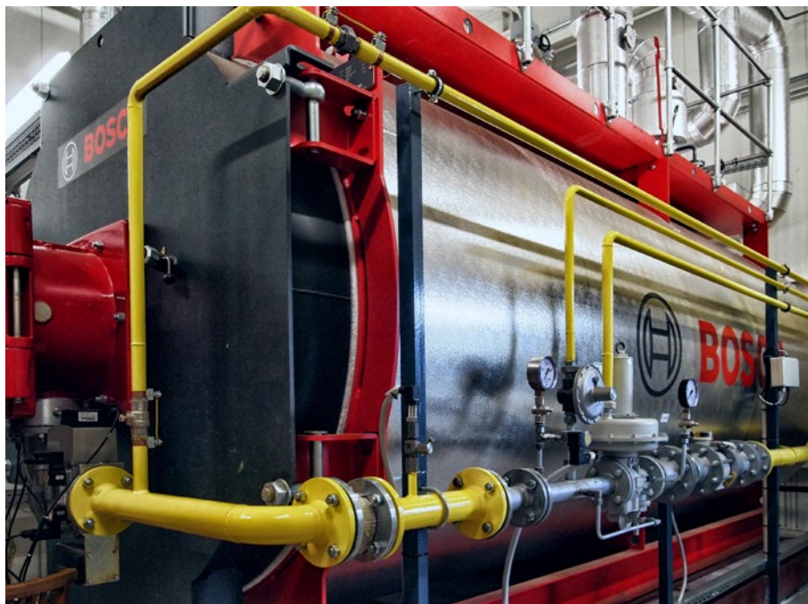
Obr. 1 – kotel na plyn 6 MW.
