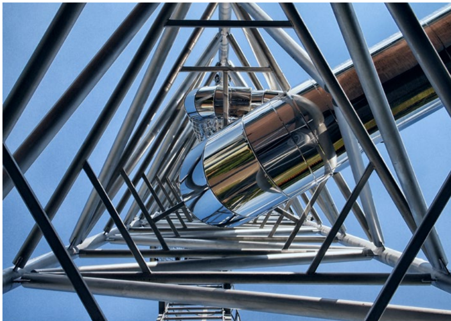
Obr. 7 – komín plynového kotle a KGJ 200 kWe – pohled zdola.
